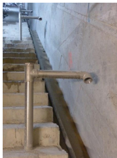
Figura 21 – Terminal de Dreno
