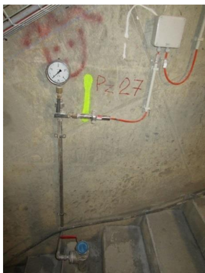
Figura 20 – Terminal de Piezómetro
